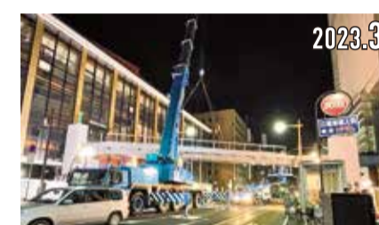
水戸市民会館と京成百貨店をつなぐ上空通路の橋脚の架橋
